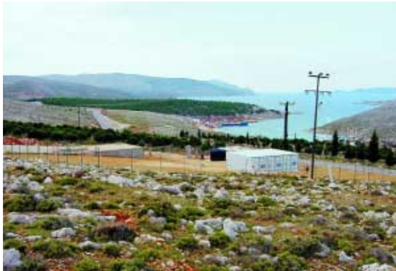
Meerwasserentsalzung auf der Insel Chios (Griechenland). Foto links: Kay Paulsen.
