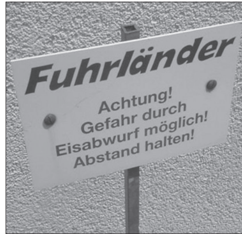
Eiswurfwarnung am Trafo, vgl. Abb. 3 (Foto: Tilman Kluge, Fuchskaute/Westerwald 7/2004)
